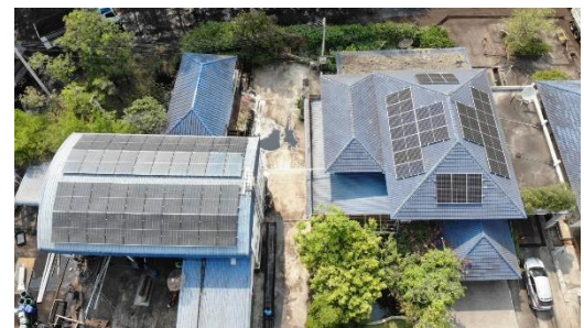
ภาพมุมสูงแสดงการติดตั้งแผง SOLAR CELLS บริเวณสำนักงานและอาคารซ่อมบำรุง
